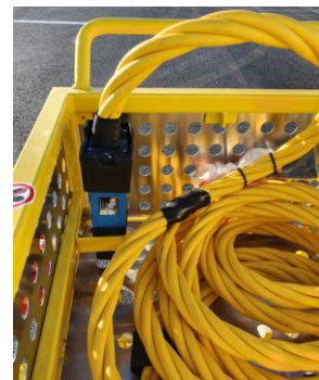
Anslutningskabeln i kabelkorgen
