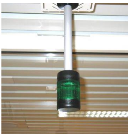
Bild 1. Utrymningslampa – Lyser vid aktiverat brandlarm.
